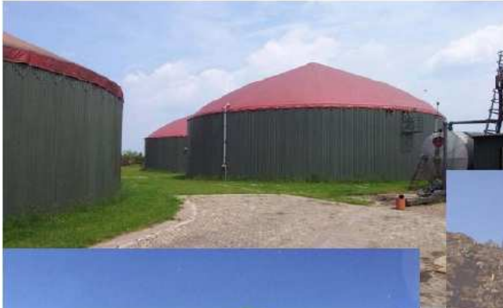
Hava Destekli Cifte Membran Kaplamali Beton Fermante Tanki
